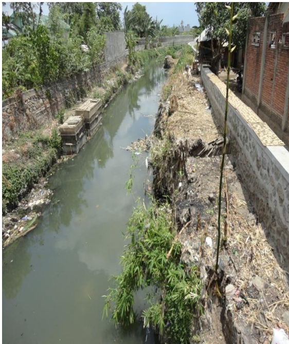
Gambar 4.3 Kondisi sungai unus (Barat jembatan dasan cermen)
