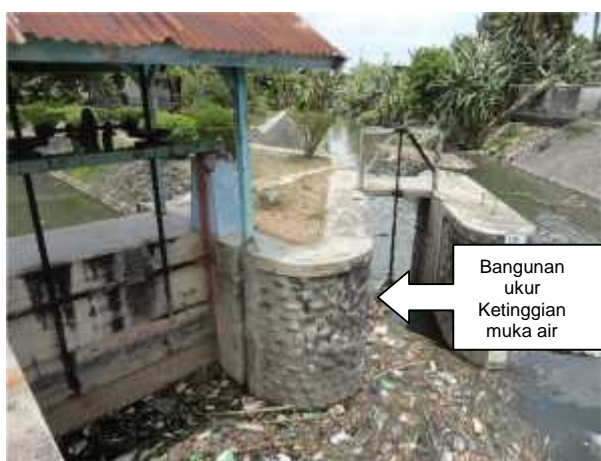
Gambar 3.1 Bangunan ukur ketinggian muka air pada Bendung Unus
